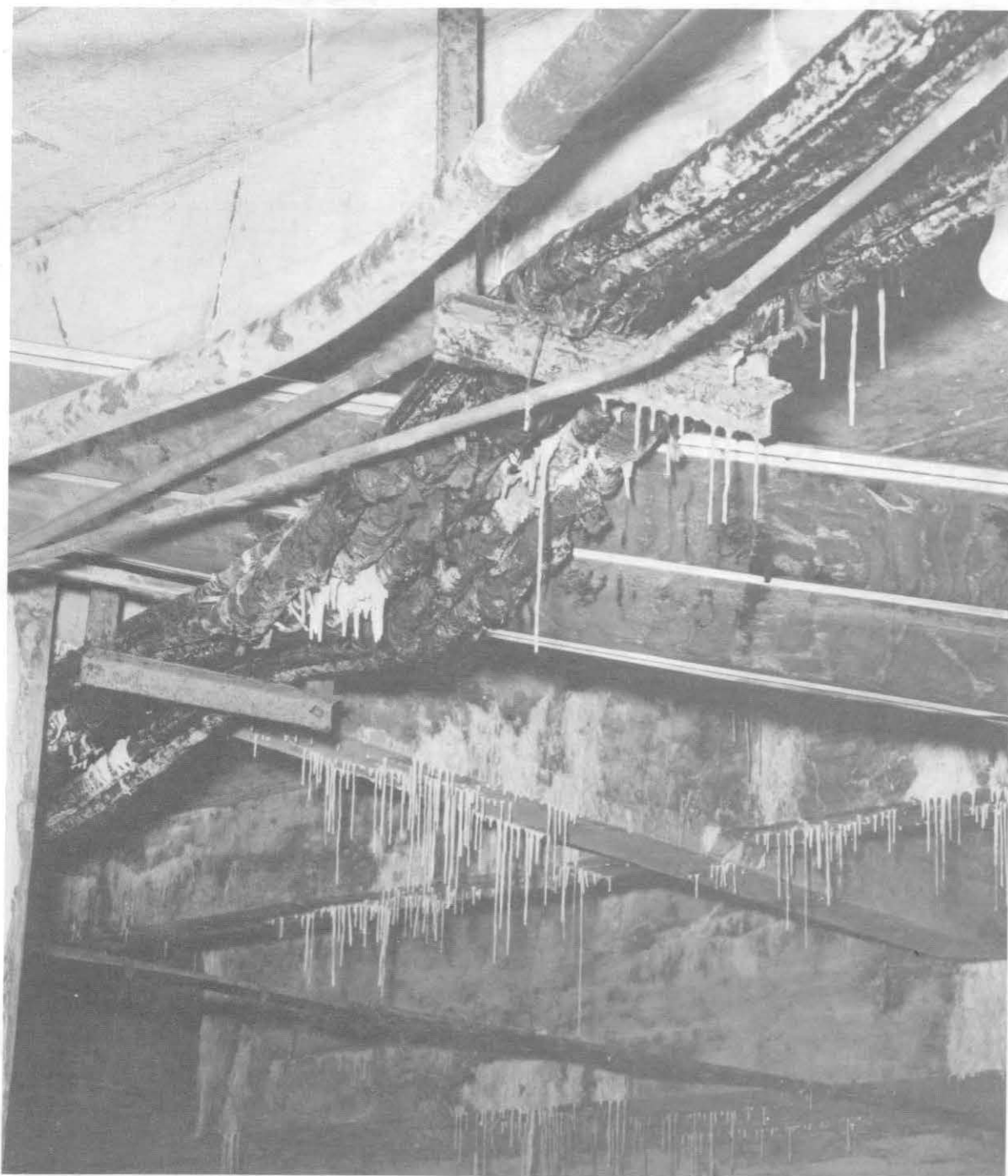
9b. BASEMENT CABLE See 9a.
