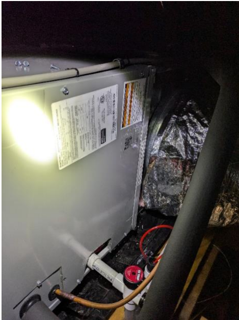
Photo M 003: Fan Coil Unit
